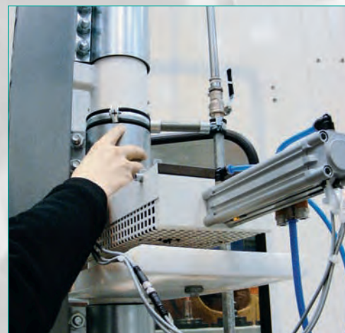
Hier wird das Ventil angesteuert, um den Unterdruck am Rohrsystem aufzubauen. Wie im Bild zu erkennen ist, bauen sie die Unterdruckrohre sehr schmal.
